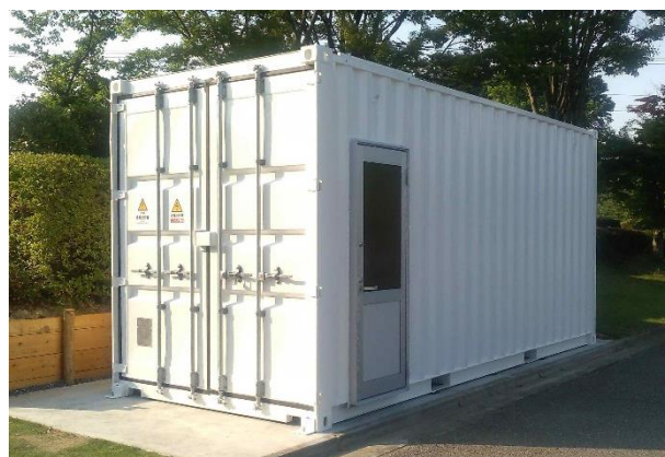
2024年7月に新設された鉛蓄電システム
